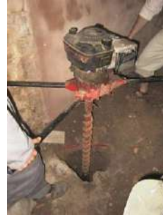
شكل(35): يوضح إجراء فحص للأساسات لمعرفة أسباب الهبوط المصدر: الباحث
