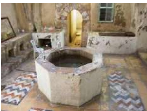
شكل(32): يوضح تحلل الأحجار وزوال القسارة المصدر: الباحث
