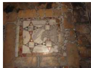
شكل(31): يوضح تكسر الأرضيات في بعض الأجزاء من المبنى المصدر: الباحث
