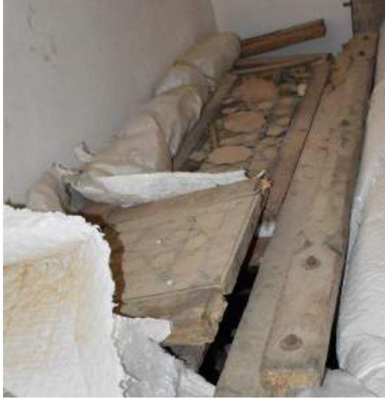
الصورة (٦) توضح تحطم الباب الى أجزاء منفصلة المصدر/ تصوير الباحث
