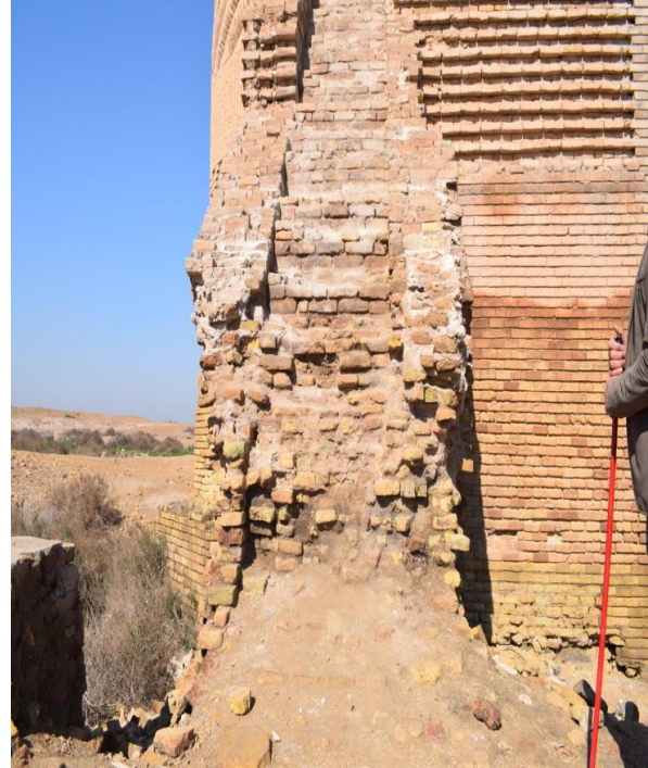
الصورة ( ٩ ) توضح أنهيار السلم لعدم الالتزام بالمسالك ( منارة واسط )
