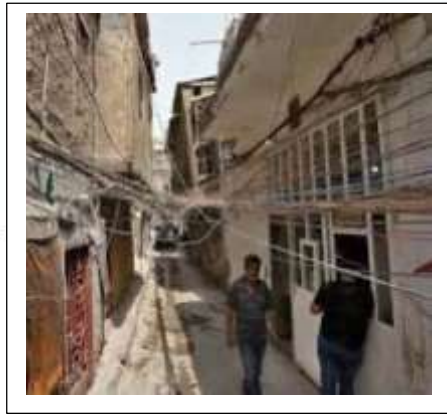
صورة رقم (٤) توضح تشابك الاسلاك الكهربائية
