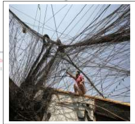
صورة رقم (٣) توضح تشابك الاسلاك الكهربائية
