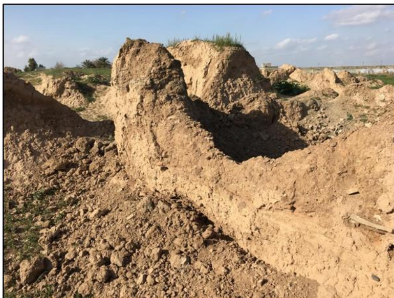
صورة (١١) انهيار أجزاء من الأطلال الطينية بتل الصوان وتأثر قمم الجدران بفعل مياه الأمطار (تصوير الباحثين)
