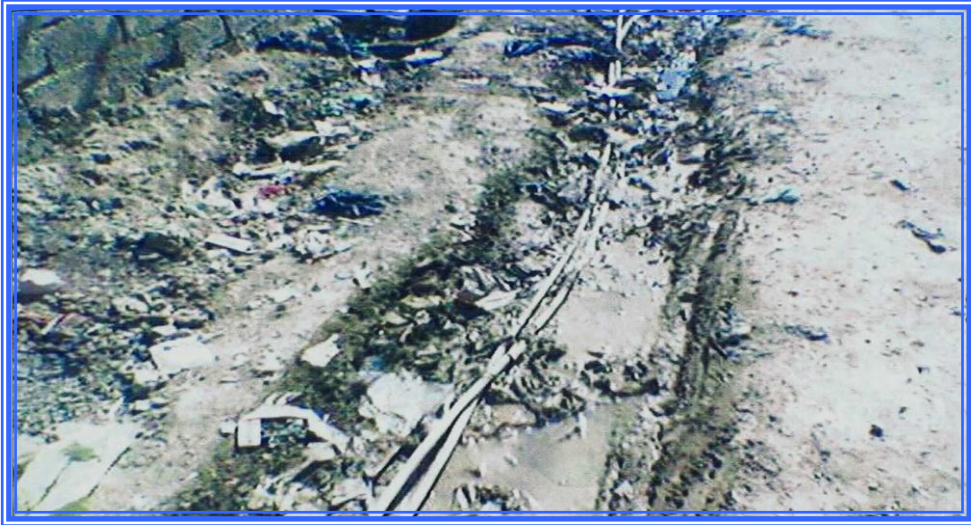
صورة (٤) أنابيب ( صوندات) المياه الممتدة مع قنوات الصرف الصحي داخل الإحياء
