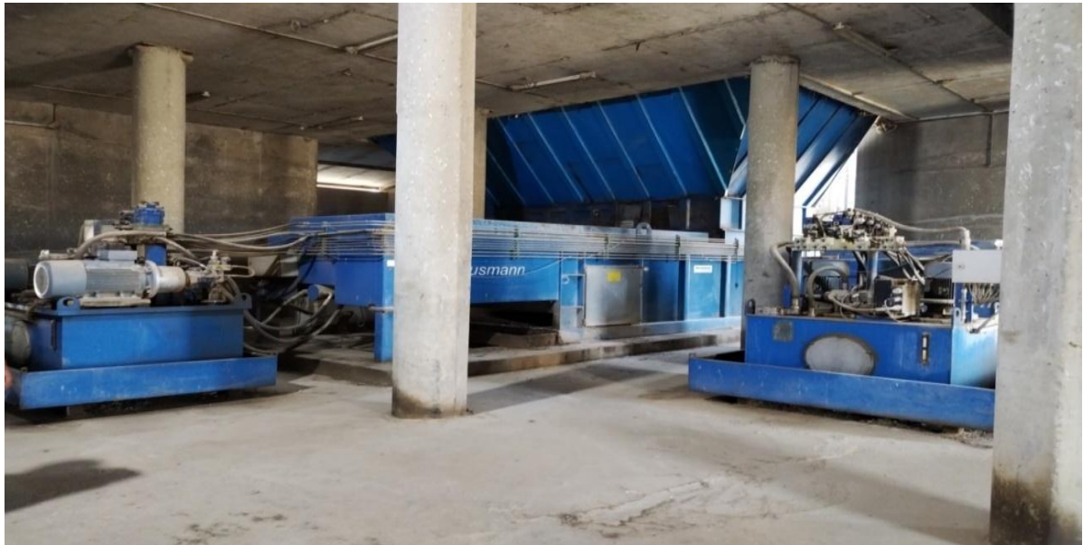
شكل (13) نظافة المحطة التحويلية النظامية (المكبس) من الداخل المصدر : الباحثين الدراسة الميدانية ، 2022
