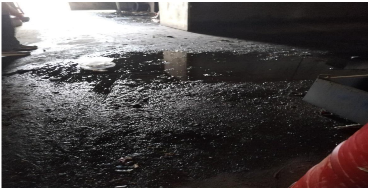
شكل (1) تآكل ارضية المحطة من الداخل وهي مغطاة بعصارة النفائات المصدر : الباحثين الدراسة الميدانية ، 2022
