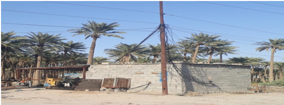
صوره رقم ( 11 ) توضح احد المولدات الاهلية في منطقة الدراسة المصدر الباحث بتاريخ 2019/10/3
