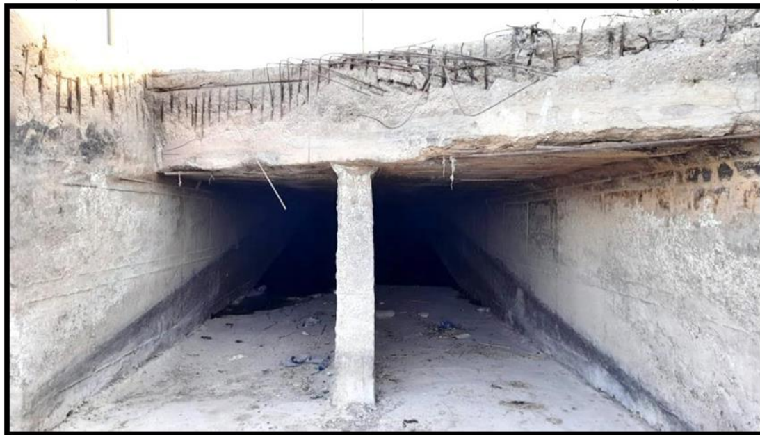
صورة (٣) النوعية الرديئة للأعمال الإنشائية وعدم مراعاة القواعد الهندسية الصحيحة في البناء
