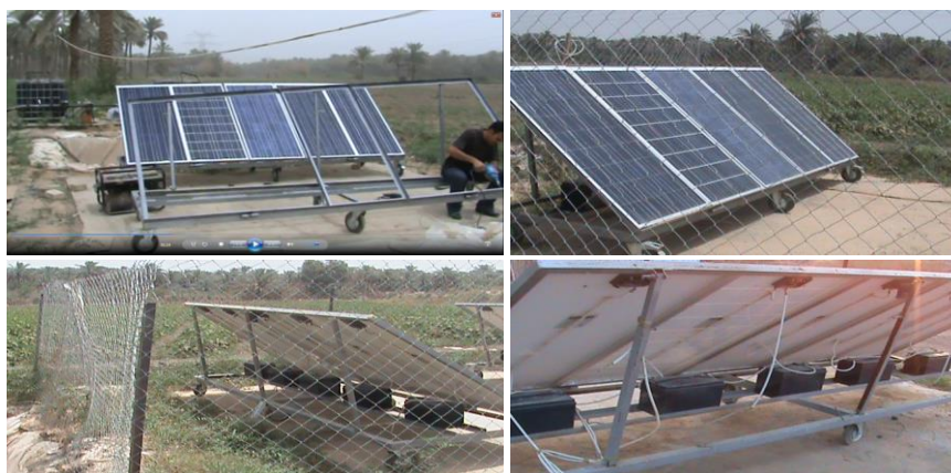
شكل رقم (9) : منظر امامية و جانبية لمحطة التوليد الكهربائية باستخدام الطاقة الشمسية مع منظومة البطاريات حيث تم تصميم الهيكل الحامل لخمس وحدات خلايا شمسية بحيث يحمل البطاريات و يحميها من الشمس
