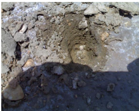
شكل ( 26 ) يوضح وجود بعض بقايا مخلفات البناء والزيت أسفل التربة
