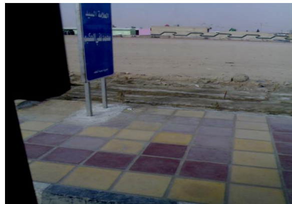
شكل (6) يوضح الملوحة العالية والتي تظهر بشكل طبقة بيضاء فوق سطح التربة
