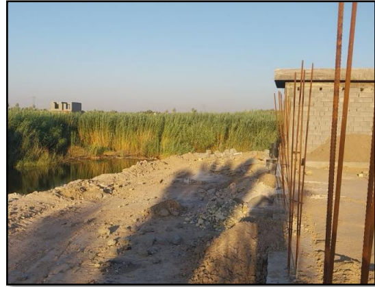
صورة (٣-١) بناء المنازل داخل المجرى بعد ردمه
