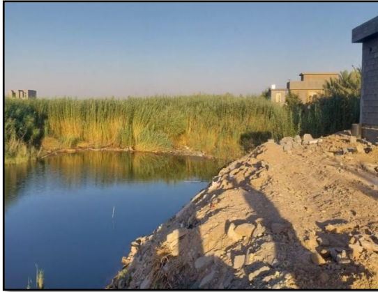
صورة (٣-٢) بناء المنازل داخل المجرى بعد ردمه
