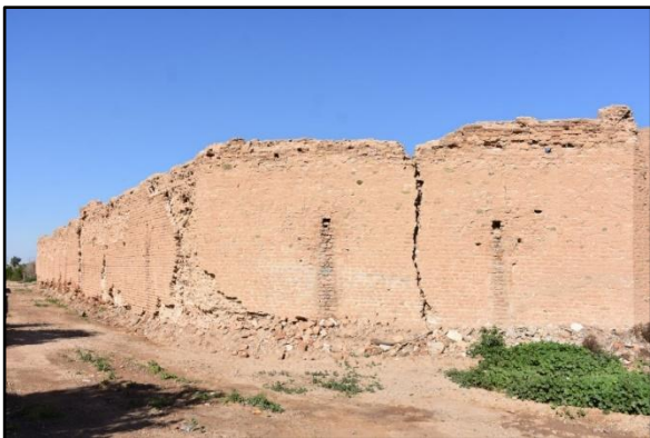
صورة رقم (٢٧) تبين تآكل وتلف في الواجهة الجنوبية
