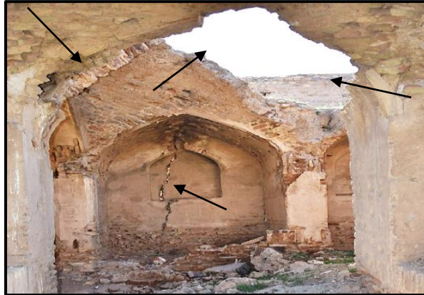
صورة رقم (٢٥) تبين سقوط جزء من السقف وتلف مواد البناء وتظهر شوخ كبير في الجدار (تصوير)
