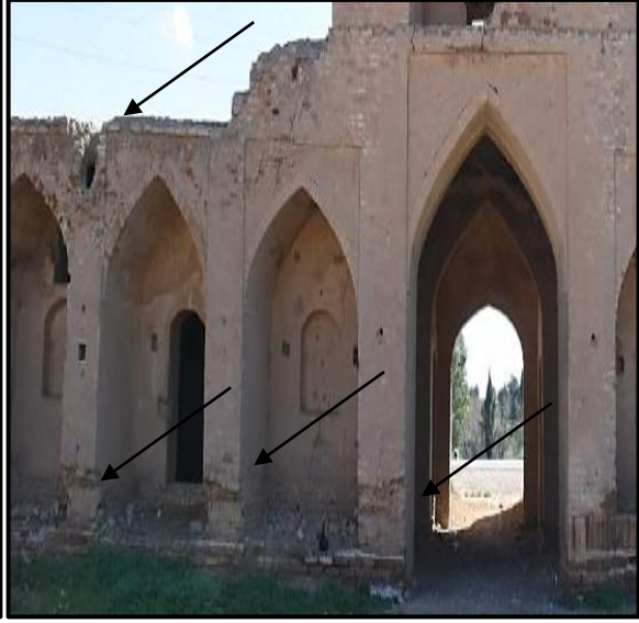
صورة رقم (١٠) تبين وتلف مواد البناء في الجهة الجنوبية للمدخل وتبين تأثير الرطوبة في الأجزاء
