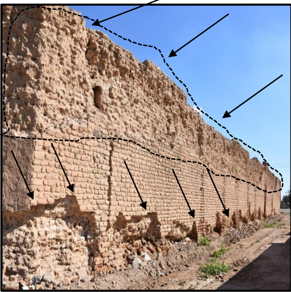
صورة رقم (١٣) تبين تآكل وتلف مواد البناء في الجدار الخرجي بشكل كبوة نتيجة مياه الامطار
