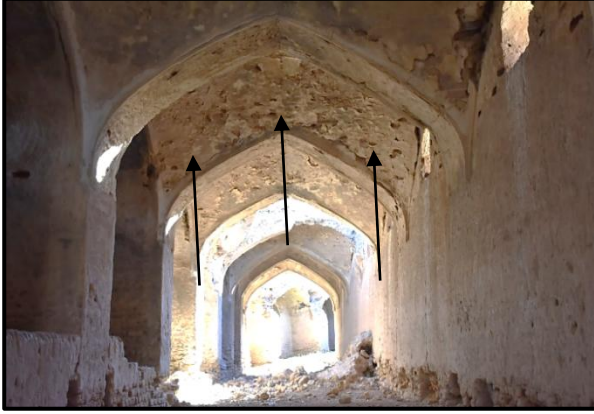
صورة رقم (٢٣) تبين تأثير مياه الامطار في سقف احدى معومات الخان حيث تظهر تآكل وتلف السقف
