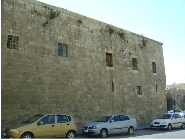
الصورة رقم (٣) توضح مظاهر التلف في الواجهة الشمالية للخان (جريان-نخر-نوافذ حديثة)(مديرية المدينة القديمة)
