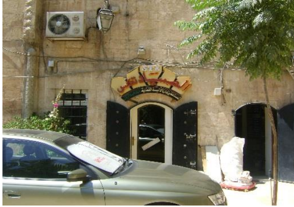
الصورة رقم (٥) توضح التجهيزات الكهربائية الظاهرة على الواجهة الشرقية (الباحث)
