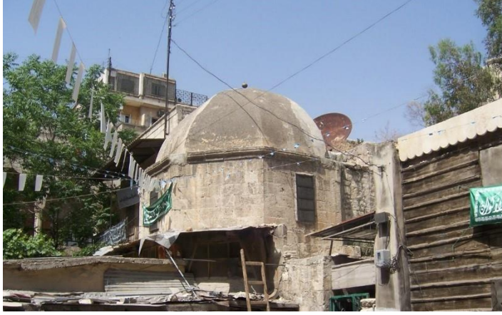
الصورة رقم (٦) توضح الكتل والإضافات المخالفة التي غطت المسجد وسط الخان (الباحث) ٥-المقترحات الترميمية:
