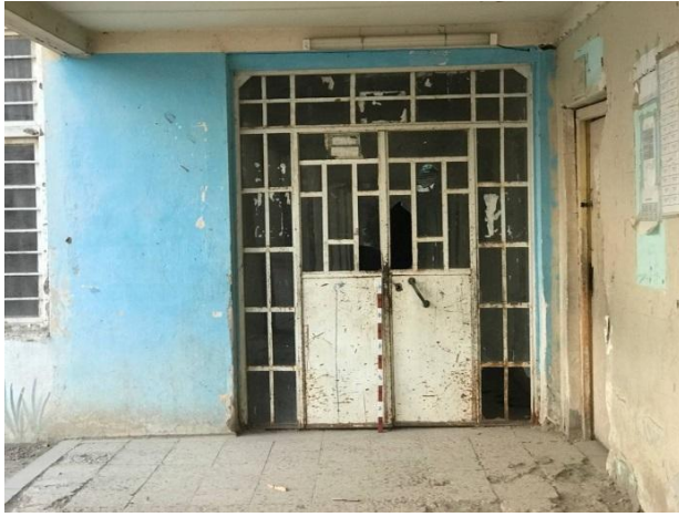
لوح (9) القاطع الحديدي الذي يفصل الموزع الثاني عن الرواق (تصوير الباحث)
