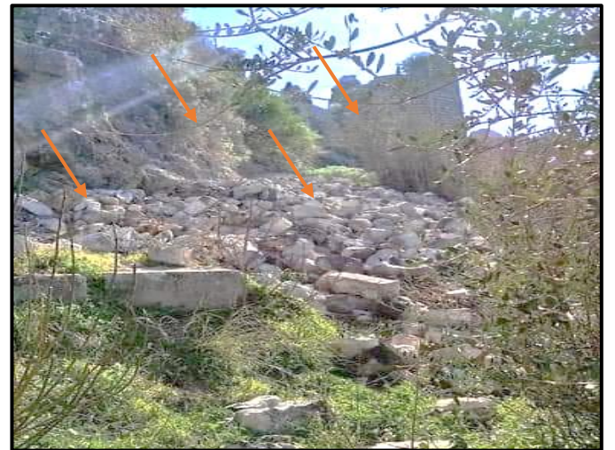
صورة رقم (٨) تبين سقوط أجزاء كبيرة من الجدران المطلة على المنحدرات الخا حبة
