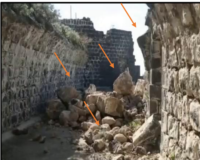
صورة رقم (٩) تبين انهيار وسقوط مواد البناء في إحدى
