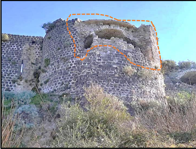
صورة رقم (٥) تبين فقدان الأجزاء الموجودة في إحدى أوج القلعة حيث تظهر سقوط أجزاء عديدة وهو حد شبه خ
