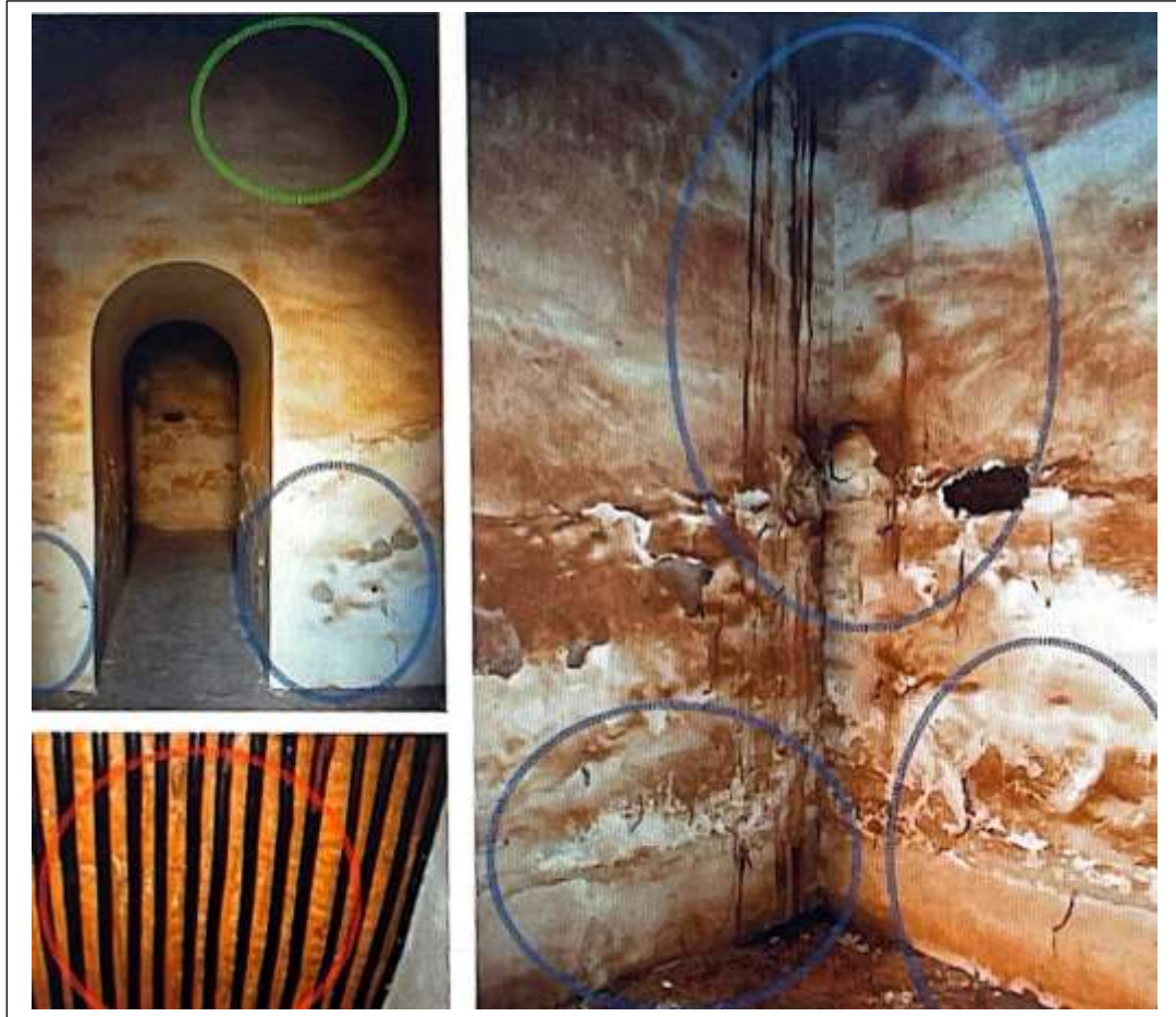
صورة رقم (6): صورة ميدانية توضح الصدمة الرطوبة والانتفاخ الطيني
