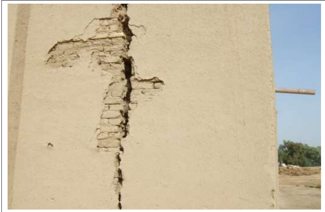
صورة رقم (7) صورة ميدانية توضح تآكل واجهة المعبد المكشوفة لصدمات حرارية مستمرة
