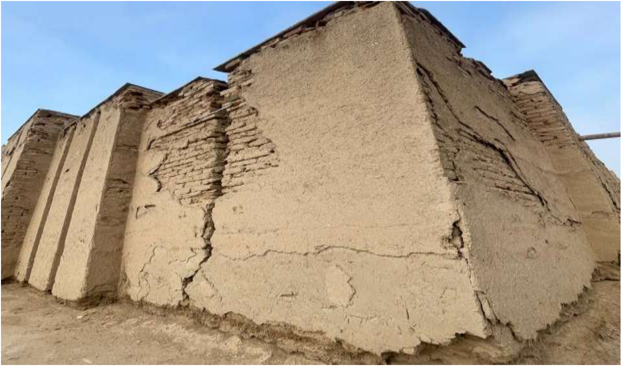
صورة رقم (3) صورة ميدانية توضح مظاهر التجوية الرياحية (Aeolian Weathering) وتفتت الأسطح السفلية لقوالب اللبن في الواجهة الشرقية لمعبد عشتار
