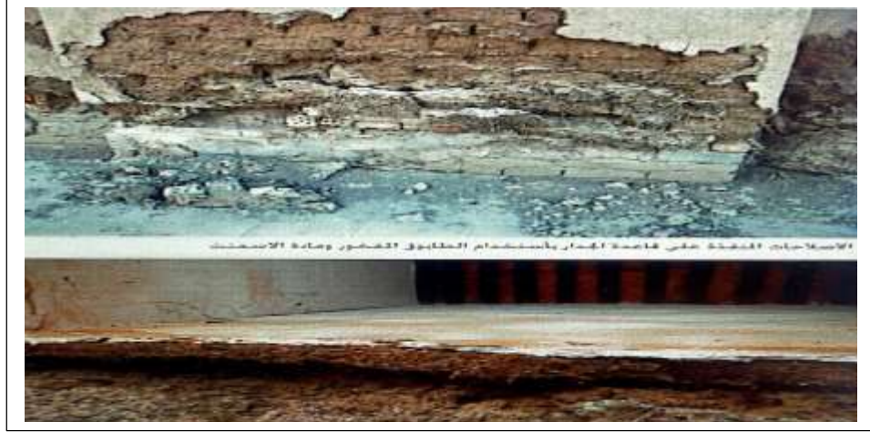
صورة رقم (9) : توضح أعمال الترميم السابقة الخاطئة والمواد غير المتوافقة لجدران معبد عشتار. مفتشية اثار بابل
