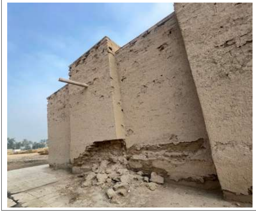
صورة رقم (4) صورة ميدانية توضح سيلان الملاط الرابط (Mortar Leaching) وتفكك مداмик البناء في الواجهة الشمالية للمعبد نتيجة السيول الموسمية
