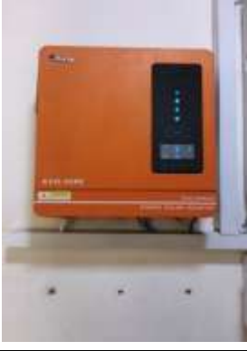
الصورة (٣) جهاز انفيرتر (Inverter)
